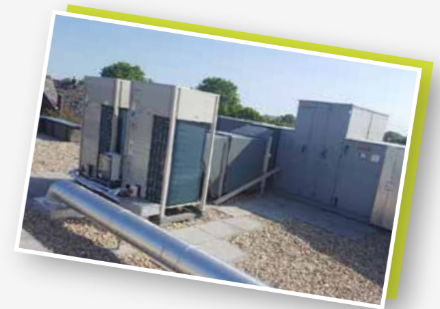
Warmtepompen en luchtbehandelingskast op dak van IKC Aaventurijn
